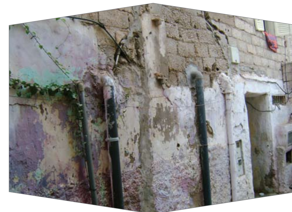
Un bâtiment menaçant ruine à Agadir-Inezgane.
