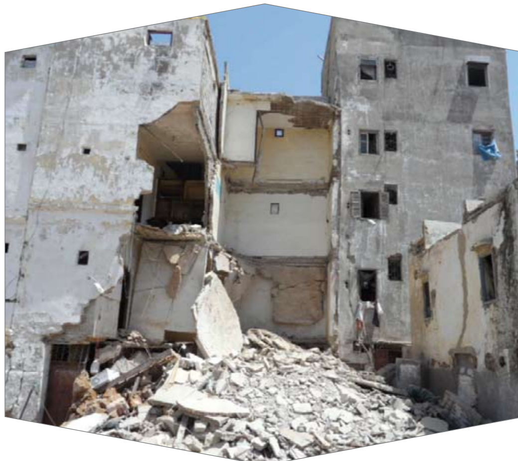
Effondrement d'un immeuble dans l'ancienne médina de Casablanca.
