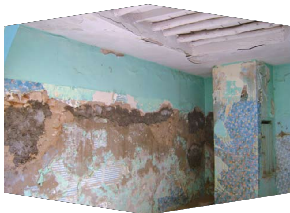
Ici des murs rongés par l'humidité et une toiture au bord de l'effondrement.
