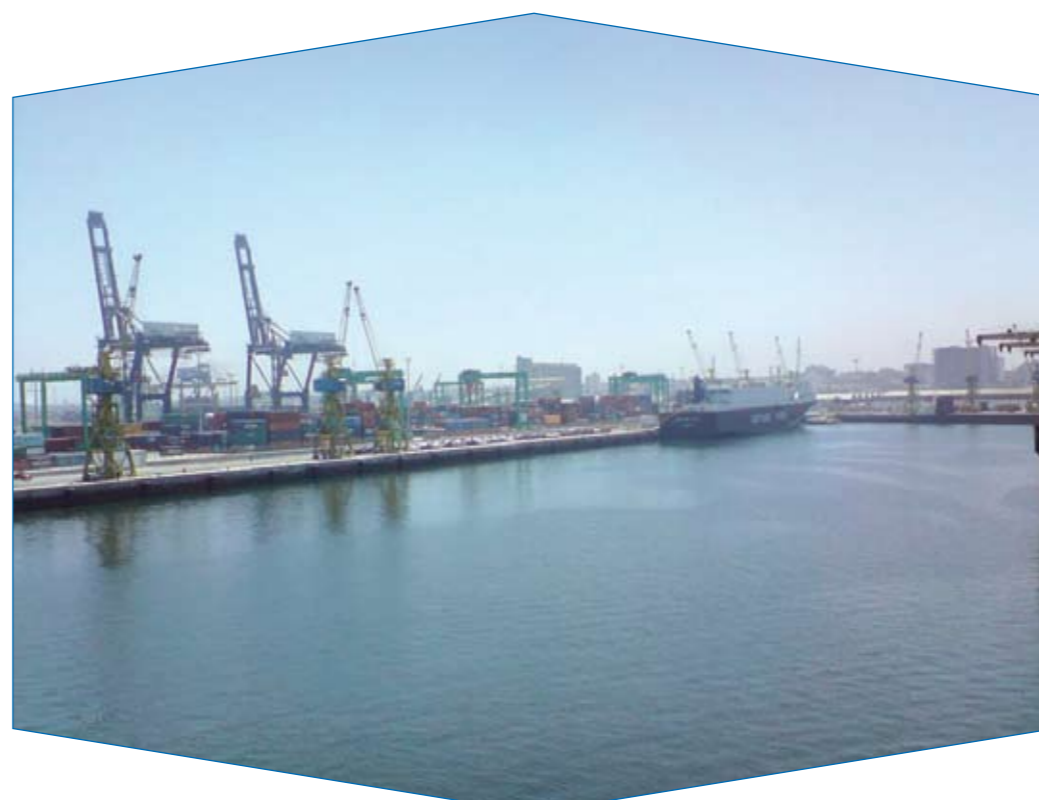
Le long des quais, il a été constaté un décollement des bétons d'angle du couronnement ainsi qu'un lessivage des bétons des surfaces.
