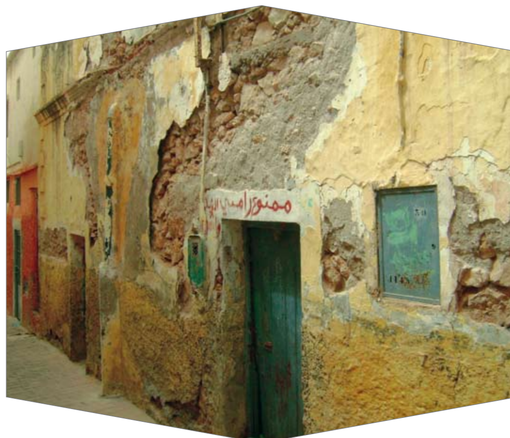
Un bâtiment dont le mur est fait avec des matériaux de mauvaise qualité.
